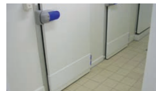
Chambres froides et locaux de surgélation
